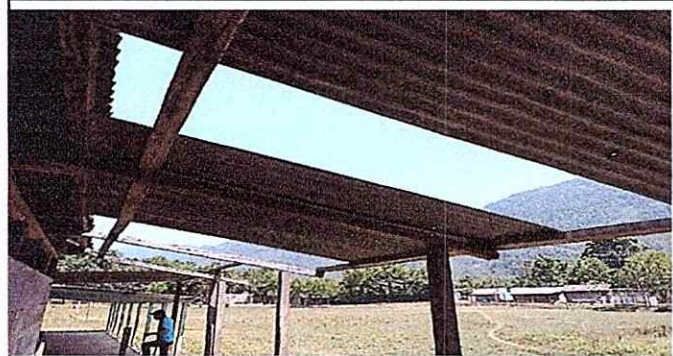
Foto 1: Laminas faltantes en el corredor de la escuela.
