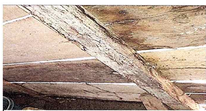
Foto 6: Postes de las paredes picados.
