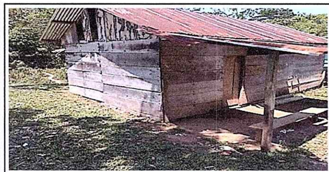
Foto 3: Paredes de la escuela picadas, quebradas, con agujeros y partes faltantes que ya se cayeron.
